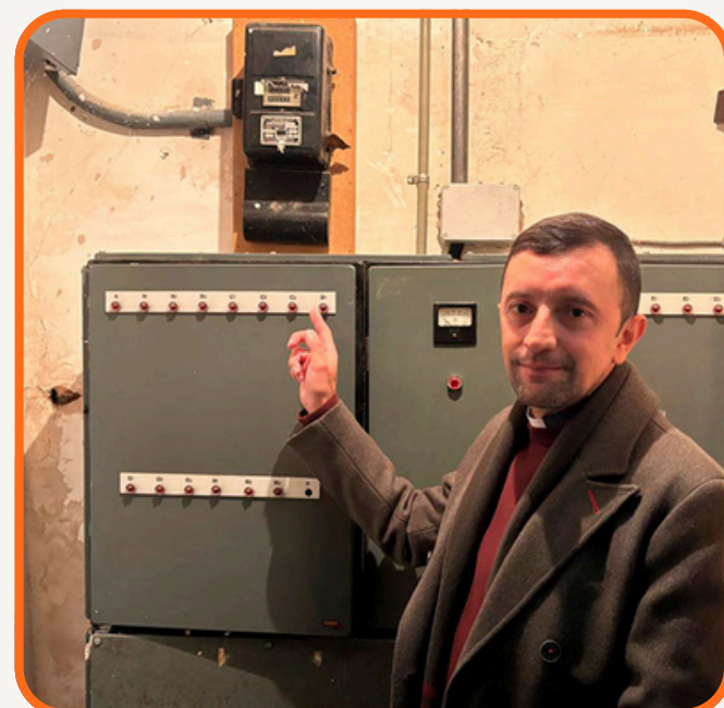
Parroquia Excolegiata de Santa María La Mayor Alcañiz -Donación Fundación SAMCA de 6.000 € para sustitución cuadro de luces
